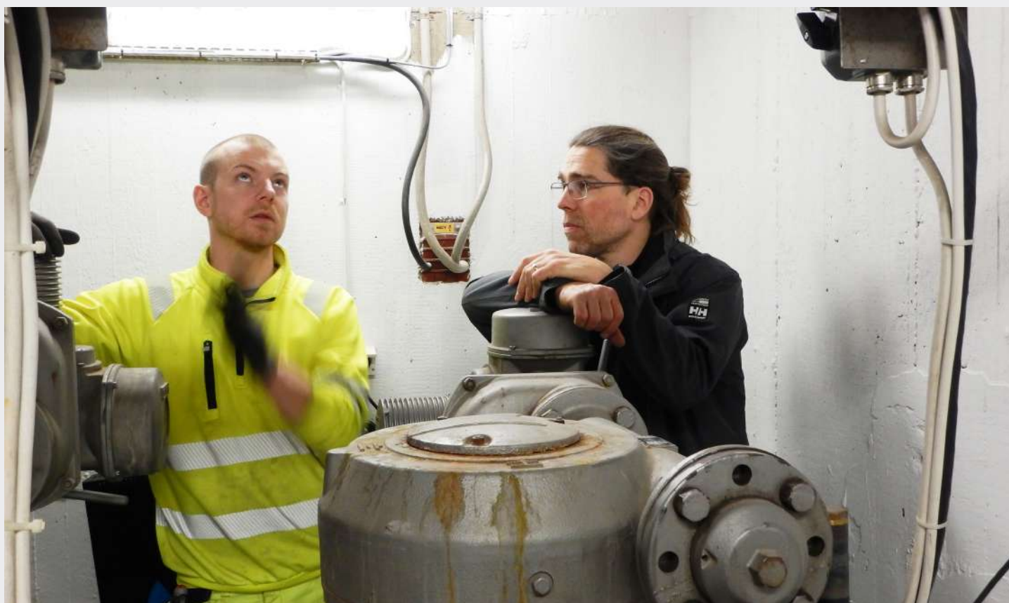
Airwatergreens servicechef Jonas Högström (till höger) tillsammans med Krafringens underhållstekniker Christian Larsson (till vänster) på plats i en av kamrarna.
