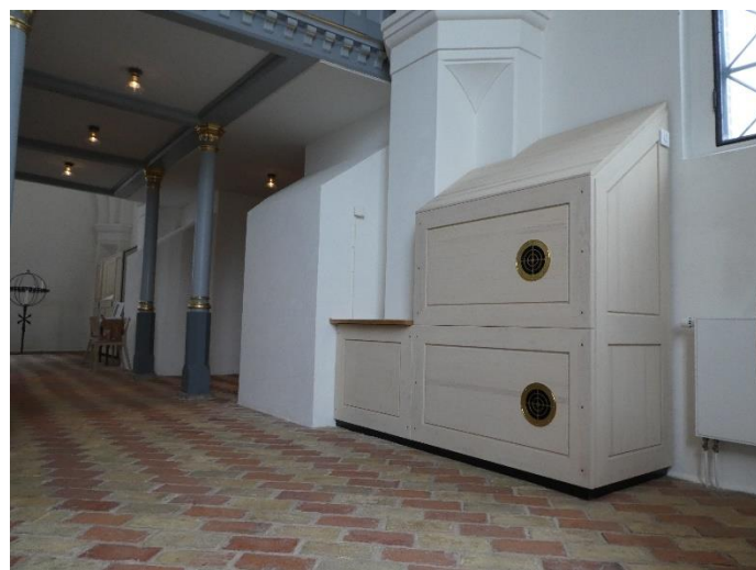
Sliparebackens finsnickeri har byggt in avfuktarna
