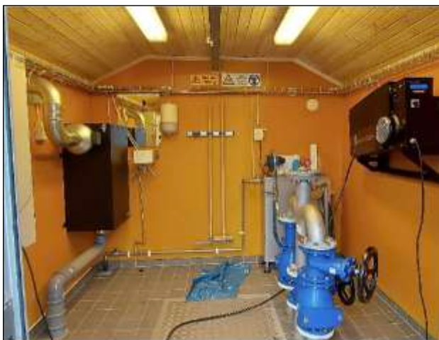
Installation av vår lösning Liuktfritt klimat där en FLEX håller luften torr och vårt kolfilter BLACKBOX tar bort svarvelväten från luften
