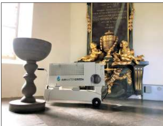
Installation i en kallställd kyrka där mycket energi kan sparas genom minskad uppvärmning. Avfuktaren FLEX står på en vagn som också är en tank för det vatten som reduceras ur luften.
