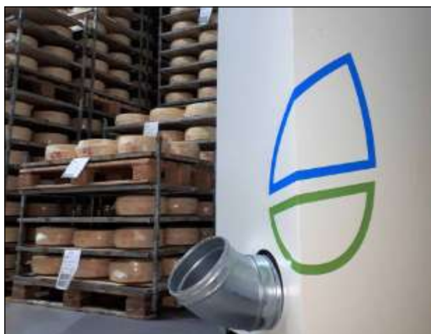
Installation av en REX luftavfuktare i ett kylager för livsmedelsförvaring. Lika effektiv vid de låga temperaturerna i lagret och enkel att omlacera då varorna placeras på annan plats.
