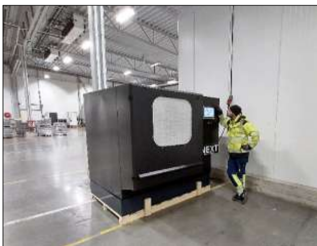
En NEXT avfuktare i ett kylager. Friblåsande installation som är möjlig eftersom fukten i luften från portarna snabbt sprider sig över rummet. Torrt i kylagret och mindre fukt i fryslagret som ligger inuti kylagret.
